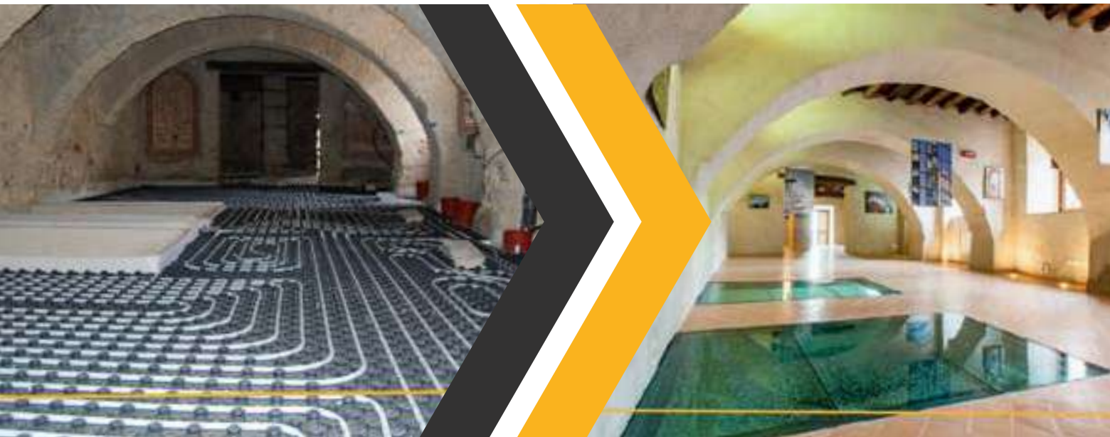
Residenza d'Epoca | Roma - Impianto radiante a pavimento con pannello Variant
