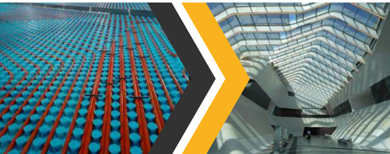
Stazione Ferroviaria | Napoli - Impianto radiante a pavimento con pannello Variplus
